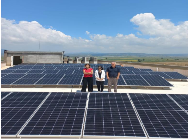
Şekil 7 . Yumurtalık Meslek Yüksekokulu Güneş Enerjisi Santrali
